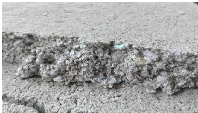
Figura 05: Vista de los paneles rotos
